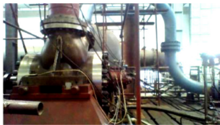
图1 现场测试装置
