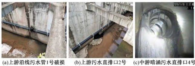
图6 DS流域沿线直排口实景照片
